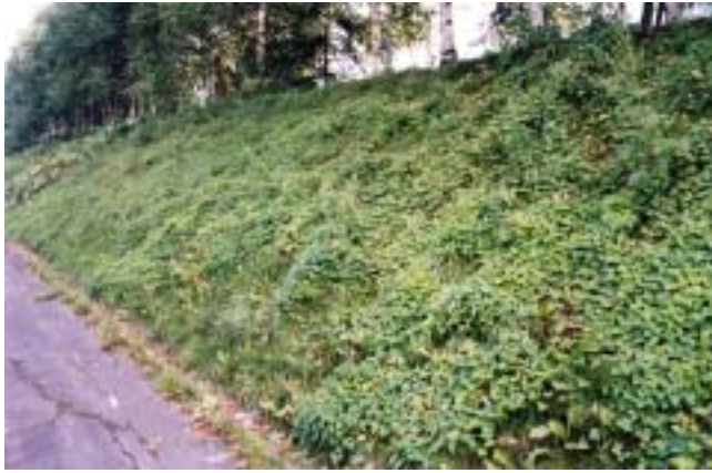
← ヤブマメの優占した切土のり面 (北海道河西郡芽室町 国道38号線)
