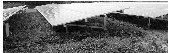
写真-2 太陽光発電場所 施工例
