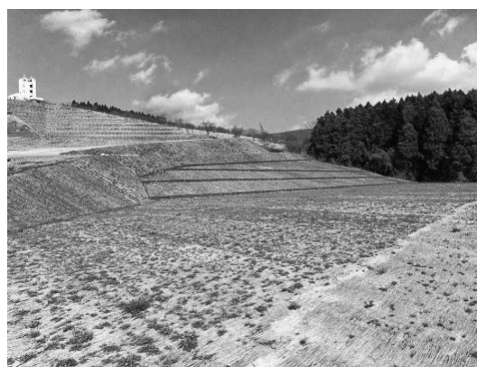
写真-2 熊本県 地震災害後の復興工事 2018年10月施工, 2019年3月(5か月後)
